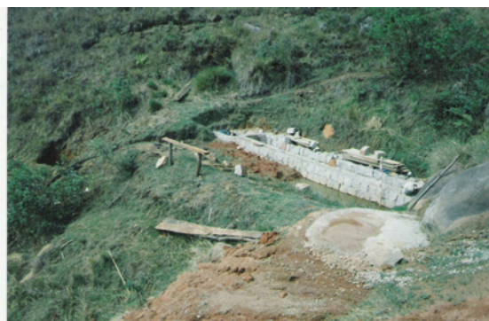
Bassin de rétention d'eau à la source
